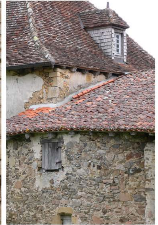
Moellons granitiques non équarris et non assisés dont l'enduit s'est délité
